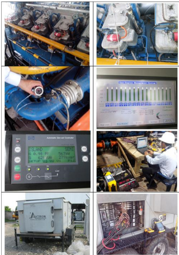
Fig. 1. Detalles de instrumentación y equipos de monitoreo del moto-generador.
