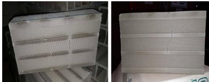
Fig. 12. Bloques con alto contenido de arena.
