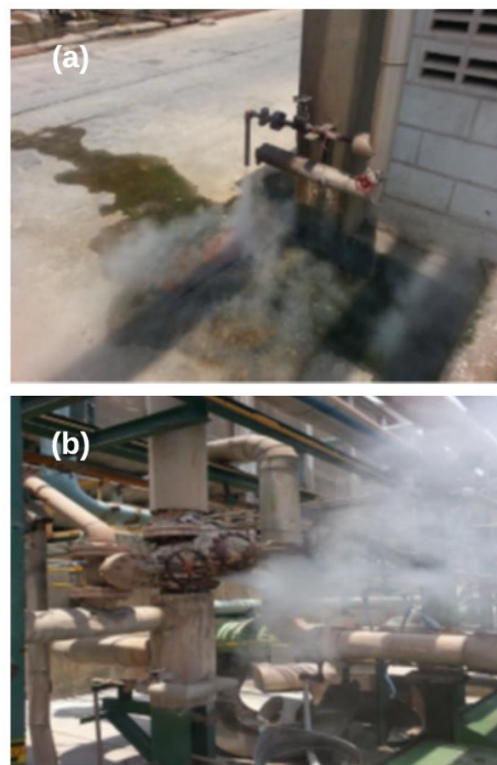
Fig. 4. (a) Trampa de vapor en mal estado. (b) Fuga de válvula de exhosto
