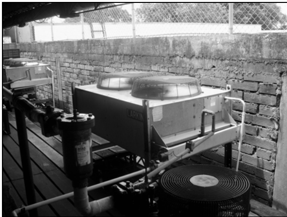
Figura 4. Condensador máquina 2 y 4
