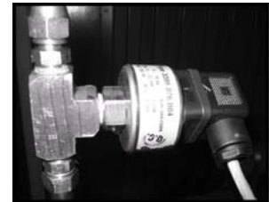
Figura 3. Sensor de presión instalado.
