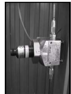
Figura 5. Sensor de caudal instalado
